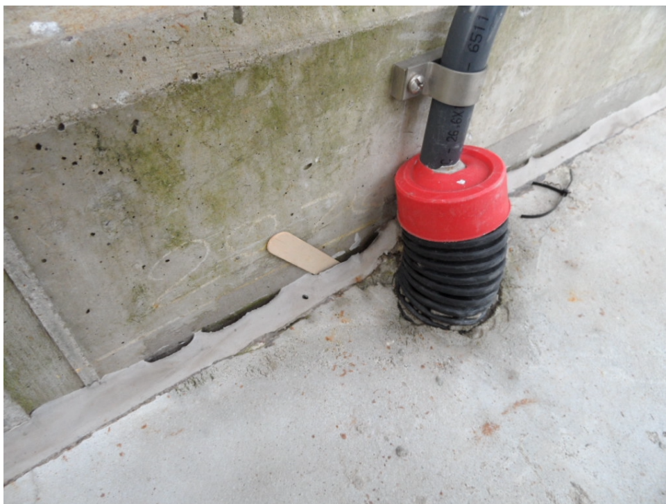
Foto: Gebrek aan afdichting.
